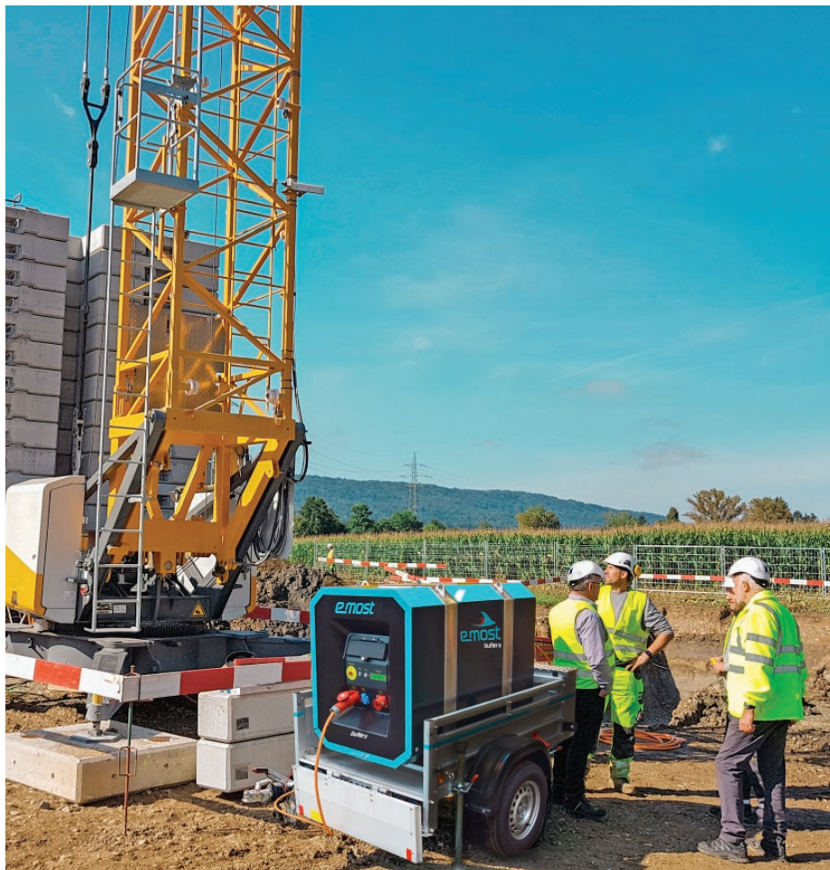
Genügend Strom auf der Baustelle dank dem umweltfreundlichen emost-«Butler s»-System.
